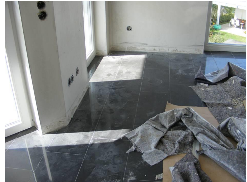
Wandseite zu Balkon: Stellfliesen entfernt, Randfuge zwischen Fliesenbelag, schw. Estrich und Wand ohne erkennbare Körperschallbrücken
