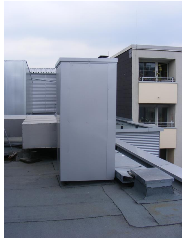
Gerät eingehaust, Luft- Auslass nach oben
