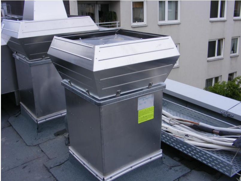
Ursprünglicher Zustand, Schallabstrahlung an den Seiten
