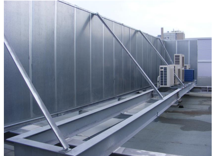
Abschirmung durch Lärmschutzwand
