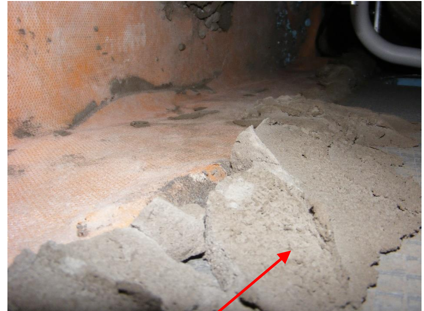
Spachtelmasse oder Mörtel überbrückt Trittschalldämmung
