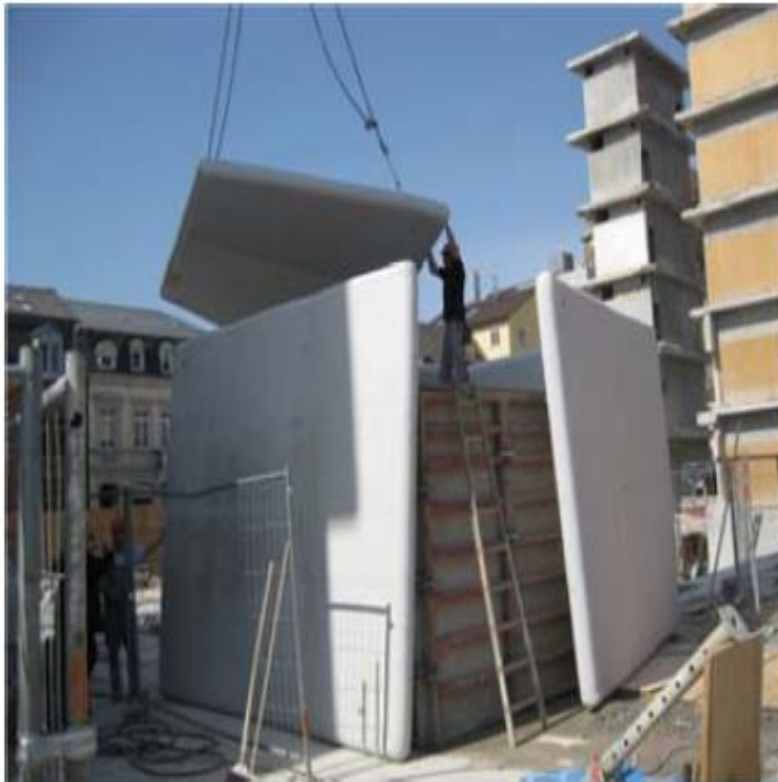
5 Lärmschutzwände 4,20 m breit x 3,30 m hoch
